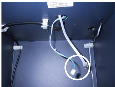
La figura 2. Cables de datos y de transmisión del dispensador.
