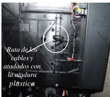
Figura 10. Sitio de la atadura plastica para atar los cables del TDM-150 (a un lado del dispensador).
